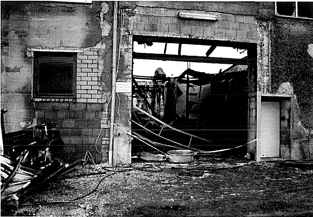
Insgesamt waren 596 Personen aus Feuerwehren, Polizei, Rettungsdienst, Technischem Hilfswerk und anderen Institutionen zur Schadensbewältigung eingesetzt. Unser Bild zeigt eine Lagerhalle des durch den Brand zerstörten Betriebes Biochema.
